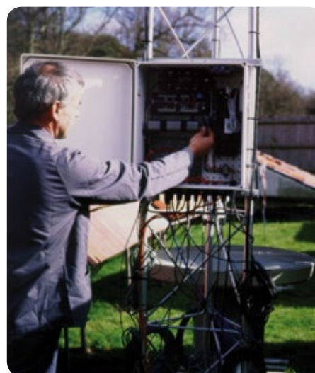
Stazione di monitoraggio di tetti campione (Ennepetal, Germania)
